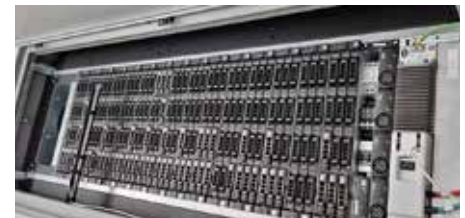
Figure 2: ANIARA Edge data center
